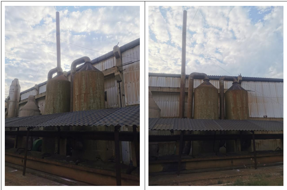
图 4-4 废气治理区照片
