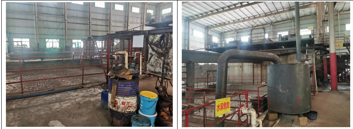
图 4-3 污水处理区照片
