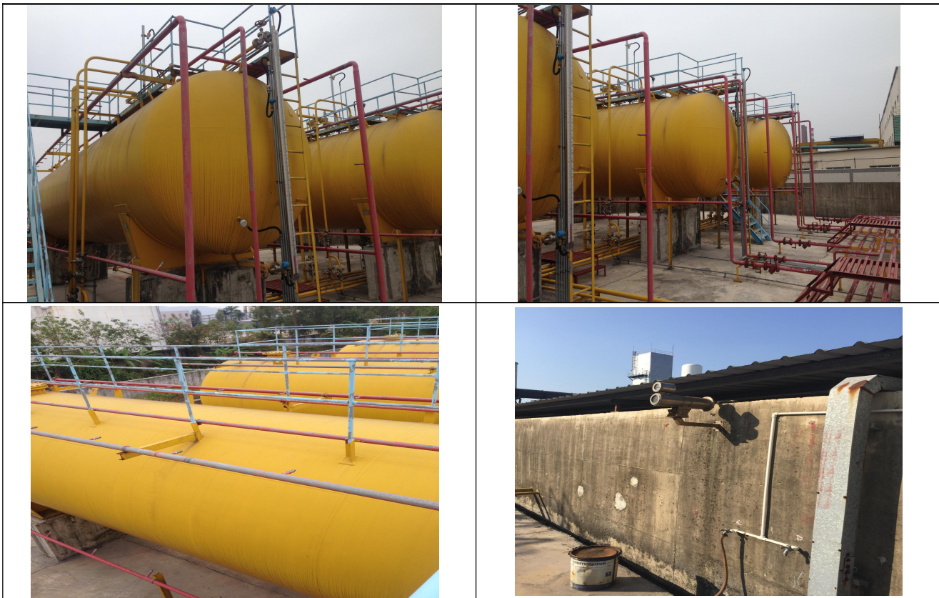
储罐区自动检测喷淋系统
