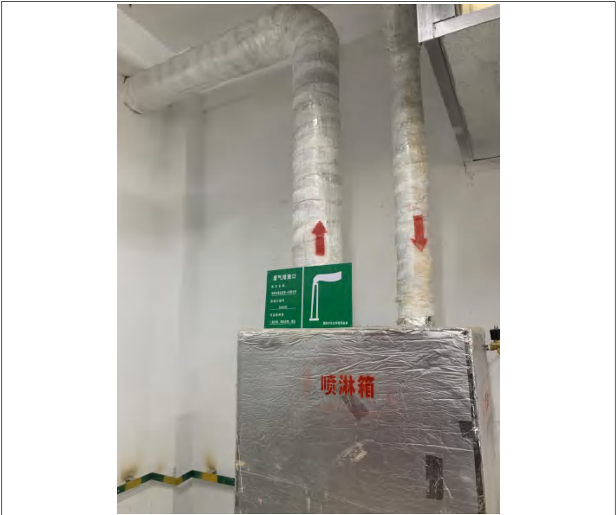
备用发电机处理设施
